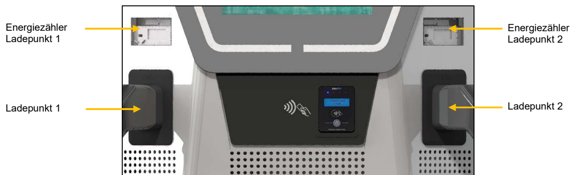
Abbildung 5: Position Energiezähler mit Public Key
